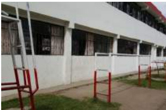
Imagen 15: Columnas cortas en el Colegio Teodoro Gómez de la Torre. Ibarra.
