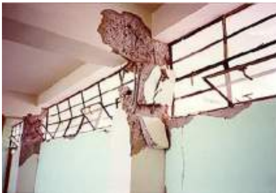
Imagen 14: Falla por columna corta en el sismo de Nazca. (Arancibia, 2016)
