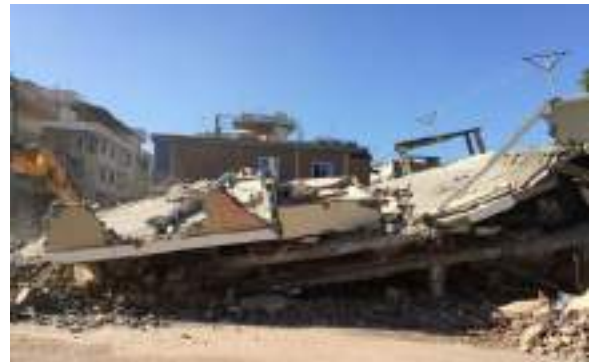
Imagen 16: Falla por colapso de columnas en el sismo de Manabí. (Suarez, 2016)
